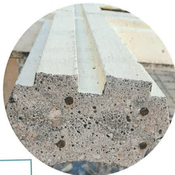
Piscine de Nérès-les-Bains Menuiserie en béton armé Vue en coupe des traverses
